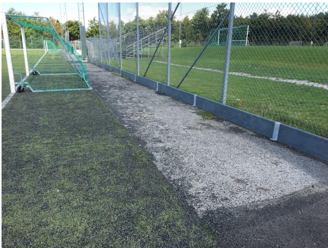
Figur 6.16. Sarg och asfalt runt planen förhindrar spridning av granulat samt förenklar att borsta tillbaka granulat till planen. (Bildkälla: Unisport.se, hämtad 2022-11-25)
